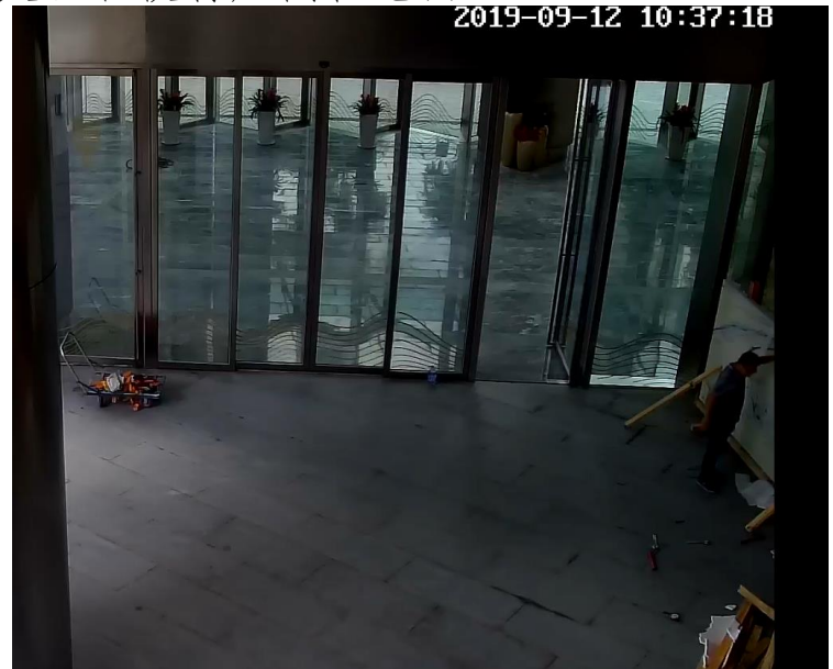
姜晋作业中（未佩戴安全防护用品）
